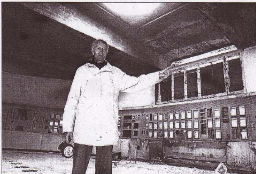
Eine neue Glaskuppel im Dach, eine alte Kontrolltafel riesigen Ausmaßes im Hintergrund: Dieter Dreßel, Bauleiter vom Architekturbüro B&M, macht aus dem alten Leitstand der Kokerei ein neues Wissenschaftszentrum. (NRZ-Fotos: Christian Kruska)
